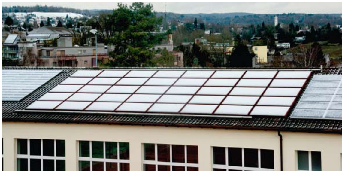
Die Solarpaneele auf dem Dach der letzten Jahr frisch isolierten Rosenberg-Turnhalle. Bild: Alfred Wüger
